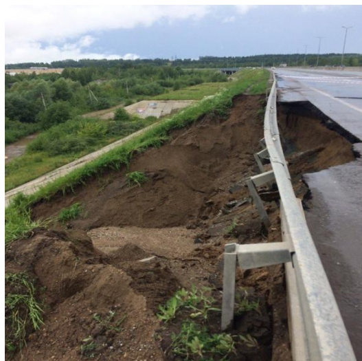
Рис. 1. Участок обрушения откоса насыпи на 51-м километре автомобильной дороги «Западный обход г. Перми» (22 июля 2017 г.)
