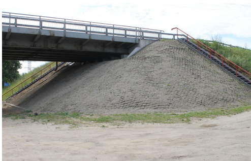
Рис. 1. Исходное состояние конуса путепровода, укрепленного объемной георешеткой
