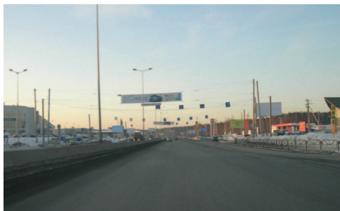
Рис. 3. Дорожное покрытие без горизонтальной разметки
