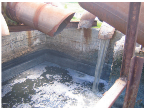
Рис. 1. Приемная камера очистных сооружений. Следы разрушений трубопроводов и стенок камеры
