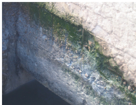
Рис. 2. Следы коррозии на стенках приемной камеры очистных сооружений
