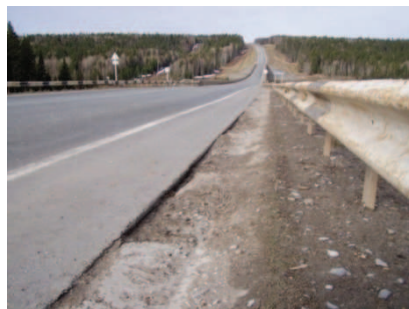
Рис. 2. Разрушенный цементобетонный лоток на автомобильной дороге «Пермь–Чусовой»
