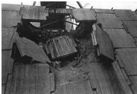
Рис. 5. Результат обрушения панелей подпорной стены [12]
