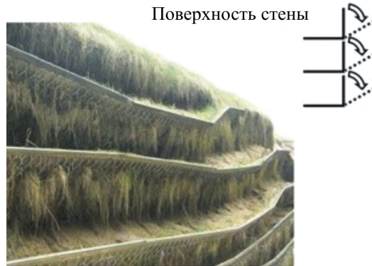
Рис. 2. Деформация армогрунтовой подпорной стены [9]
