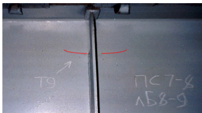
Рис. 6. Стенка продольной балки с трещиной Т9
