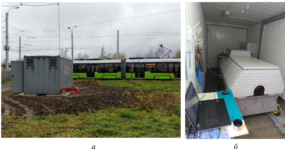
Рис. 4. Контейнер с накопителем энергии НКЭ-3Г во время работы в КС трамвая (а); внешний вид накопителя (б)
