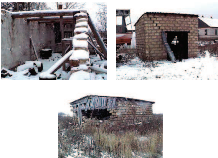
Рис. Примеры разрушенных сооружений для хранения пестицидов [1]
