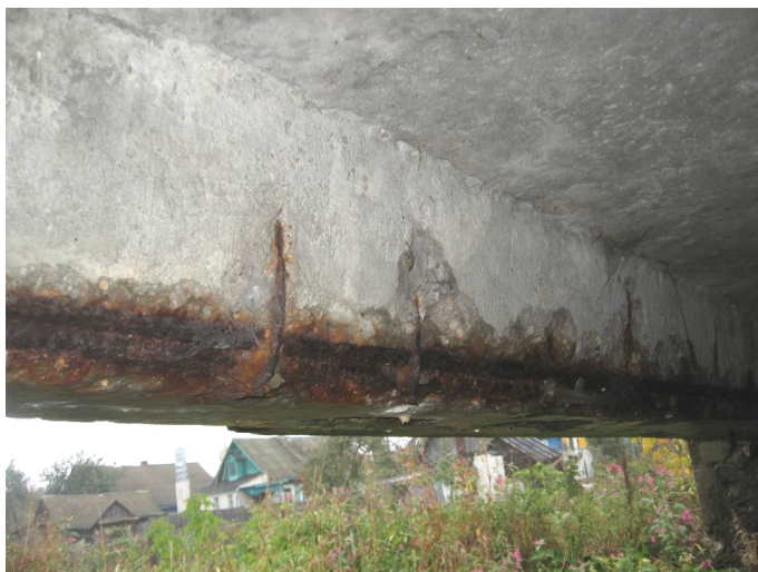
Рис. 2. Мост через р. Дунайчик в г. Смолевичи: размораживание бетона плиты П1 в пролете № 1, оголение и коррозия арматуры
