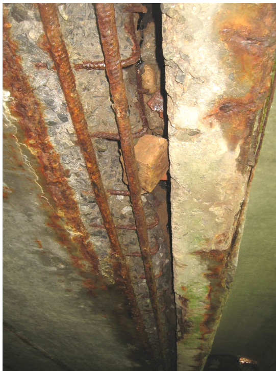
Рис. 3. Мост через ручей на а/д Р-62 Чашники – Бобр – Бобруйск: размораживание бетона плиты, коррозия арматуры, выключение из работы крайнего стержня в результате потери сцепления с бетоном
