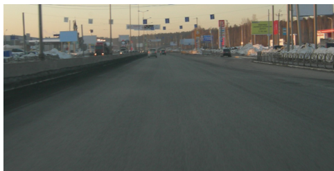
Рис. 3. Дорожное покрытие без горизонтальной разметки
