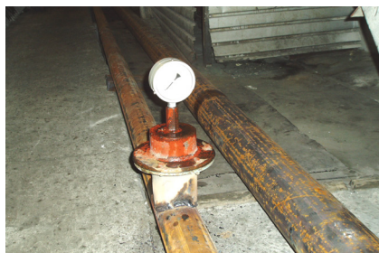
Рис. 3. Линейная часть экспериментальных трубопроводов с установкой манометров и разделительных сосудов
