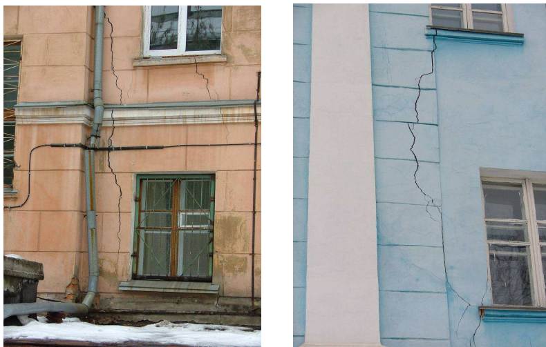
Рис. Фрагменты фасада здания стоматологической клиники ГОУ ВПО «Пермская государственная медицинская академия». Сквозные трещины
