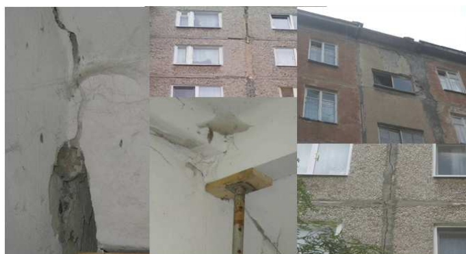
Рис. 2. Разрушение конструкций панельных зданий
