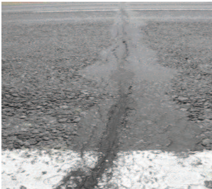
Рис. 2. Пример разрушения поперечного шва цементобетонной дороги от резонансного воздействия
