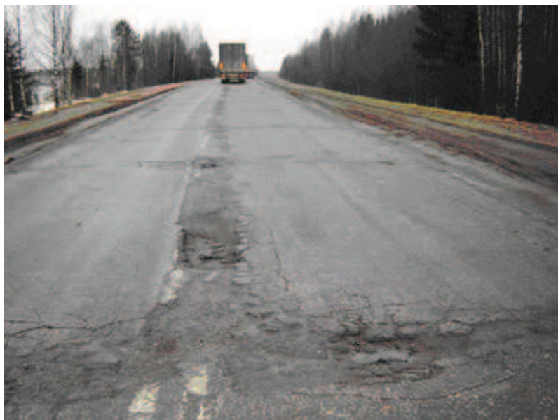
Рис. 1. Повреждение цементобетонного покрытия от воздействия сурового климата и тяжелых транспортных нагрузок
