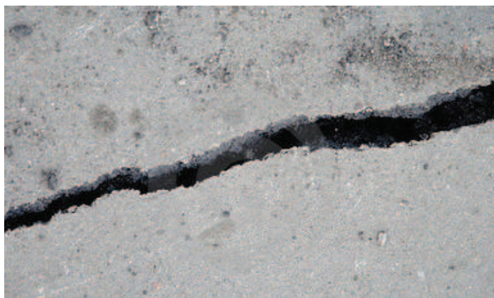
Рис. 1. Цементобетонное покрытие дороги треснуло!
